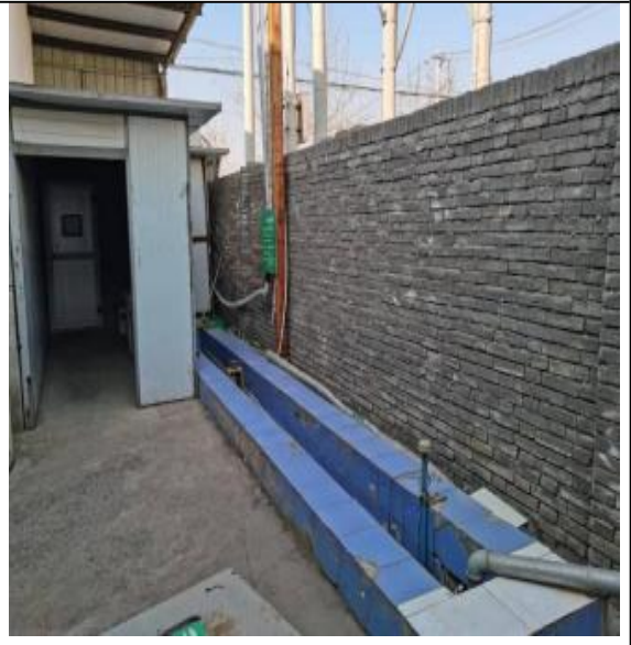
污水站在线监测室
