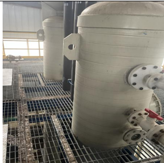
乳化液线工艺线内的废气吸收装置
