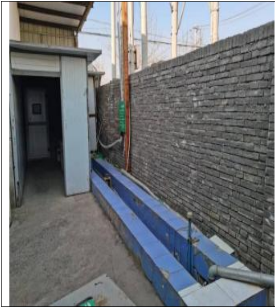
污水站在线监测室
