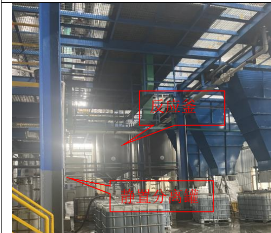
废乳化液生产线
