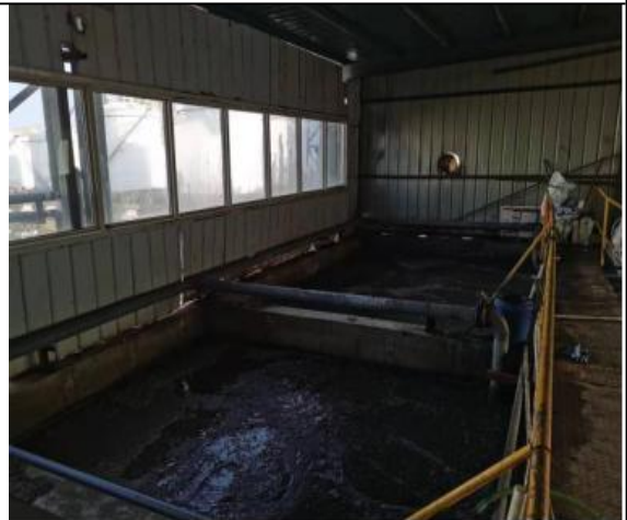
综合污水站（生化段）
