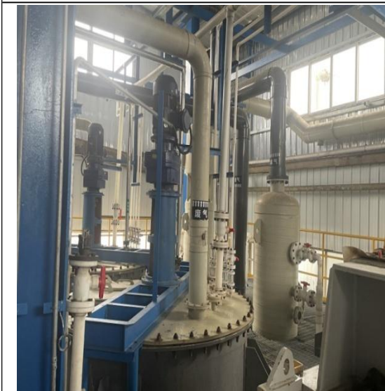
反应釜废气管道
