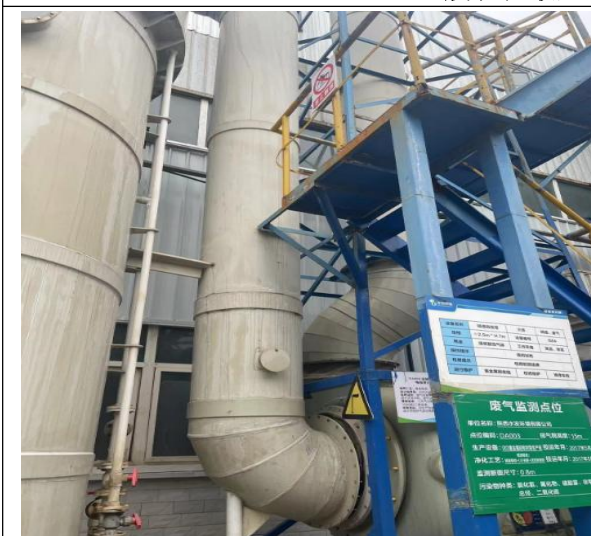
碱液吸收塔+DA003
