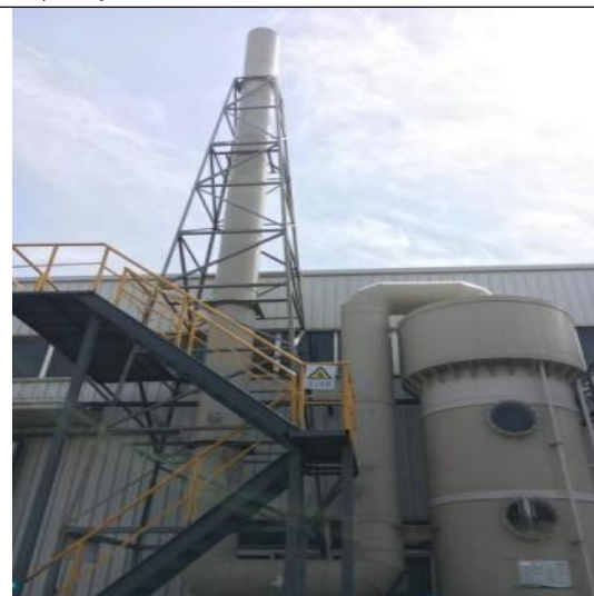
碱液吸收塔+DA004
