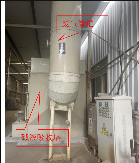
废气管道及处理设施
