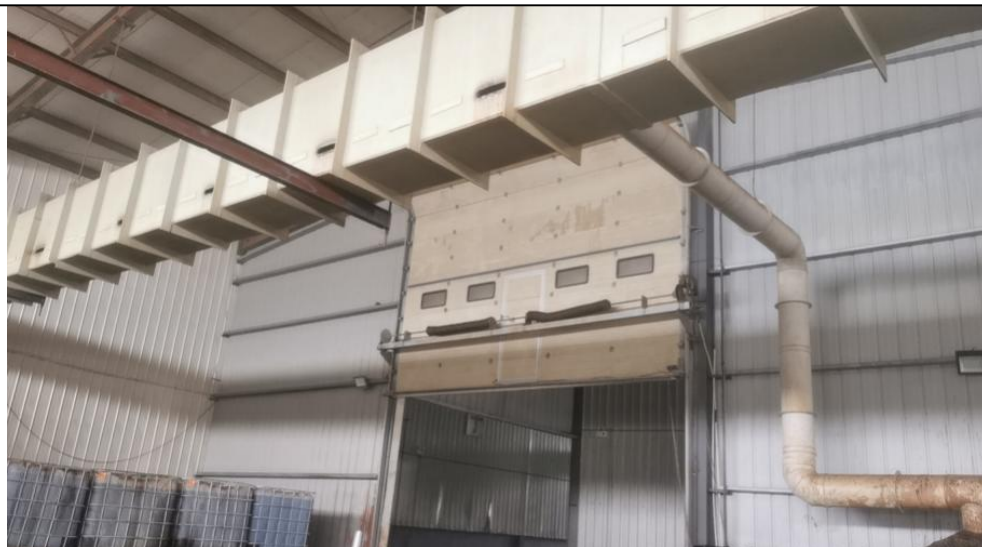
废气收集装置
